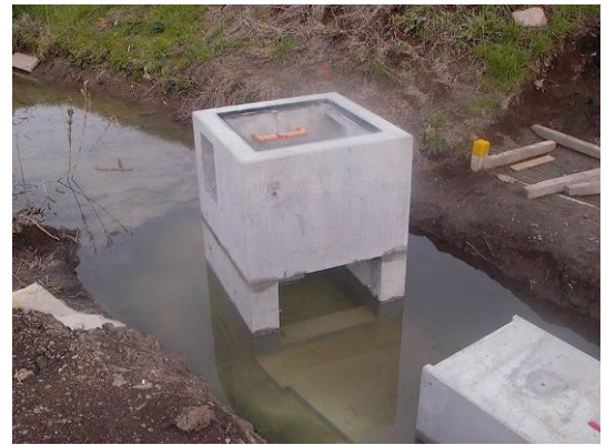
写真-3 コンクリート製集水枡(下は図-3に示す5段の土のうで地盤補強されている)
