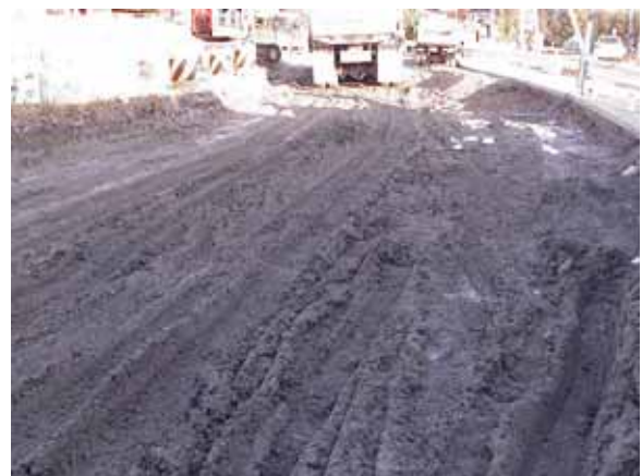
写真-15 掘削後の水浸軟弱地盤
