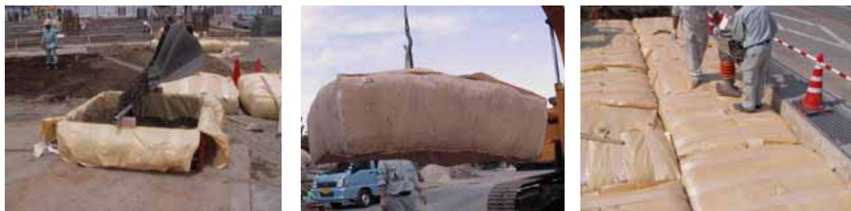
1)重機を使い上部より資材を投入し上面を閉口 2)LSを吊上げ移動し所定位置に設置 3)敷設後十分転圧を行い設置完了
